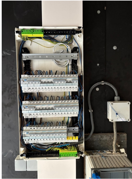
( Elektrisch bord - binnenkant )
